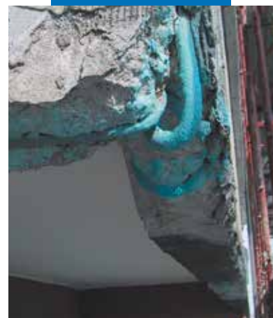
Armeringsjárn som behandlats med Mapefer 1K på framsidan av en balkong
